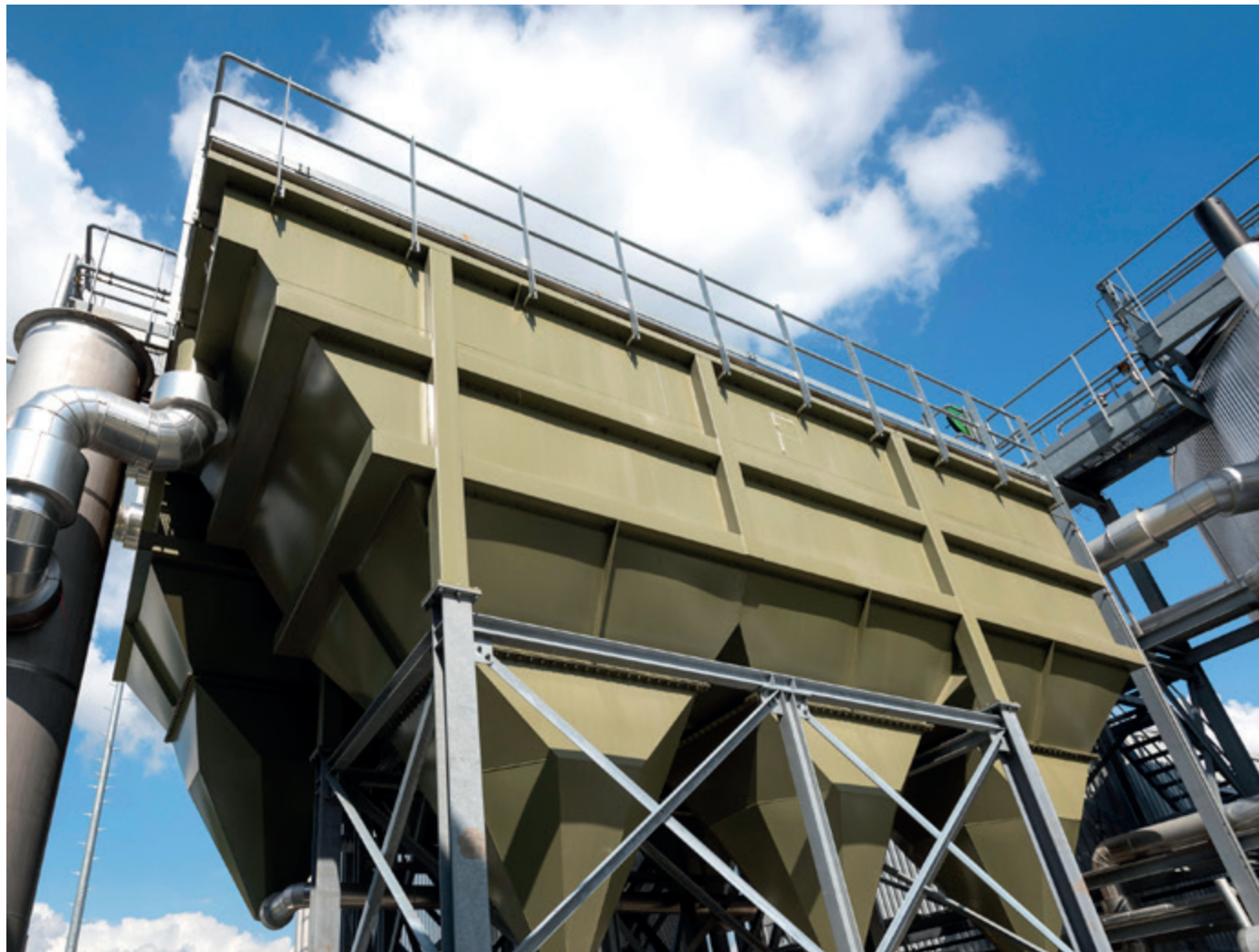
Energiefabriek RWZI Tiburg Noord
