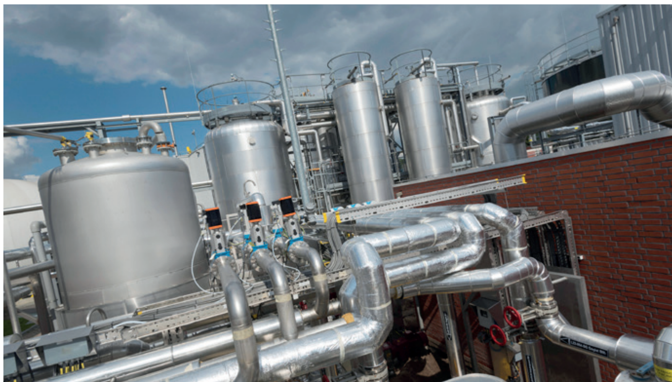
Energiefabriek RWZI Tiburg Noord
